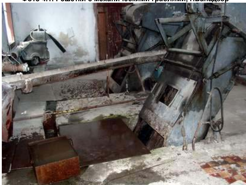
Фото 4.1. Решетки с механическими граблями, г.Ванадзор
